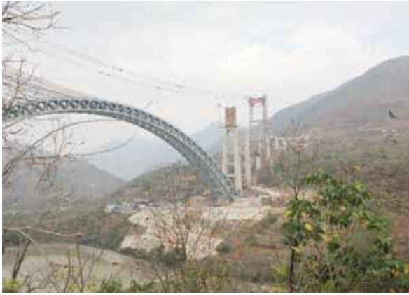
写真7) アーチ接合に成功した建設中の怒江四線特大橋 (於惠通橋付近)
